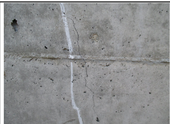
A1 벽체 균열 발생
