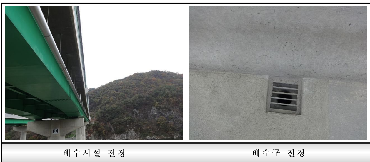
【표 2.1-2】 배수시설 손상물량
